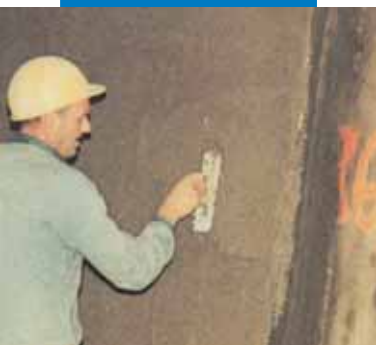
Tencuiala pe baza de ciment cu Planicrete. Tunel autostrada Ville Marie, Montreal, Canada
